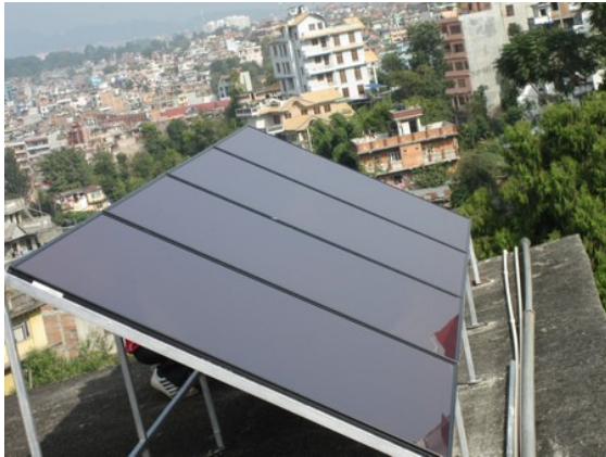
De 4 panelen staan op het dak boven de keuken
